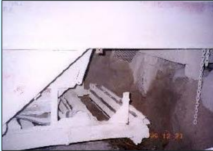
Fig. 45 Ubicación donde ocurrió el incidente
