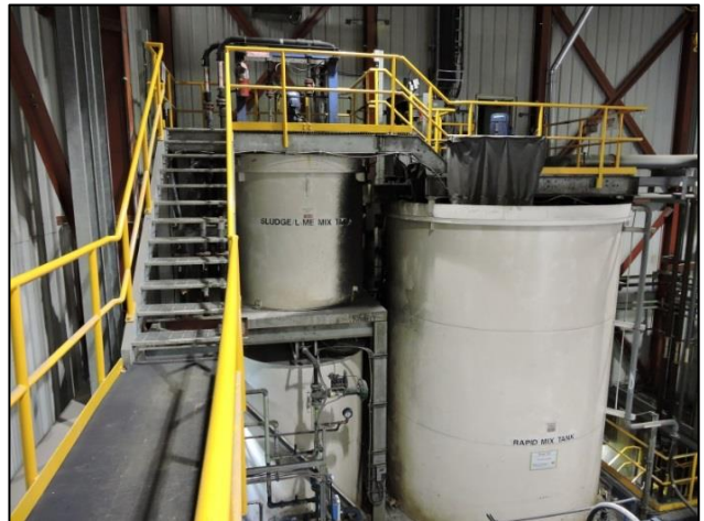
Fig. 24 Existen peligros mecánicos dentro de los tanques
