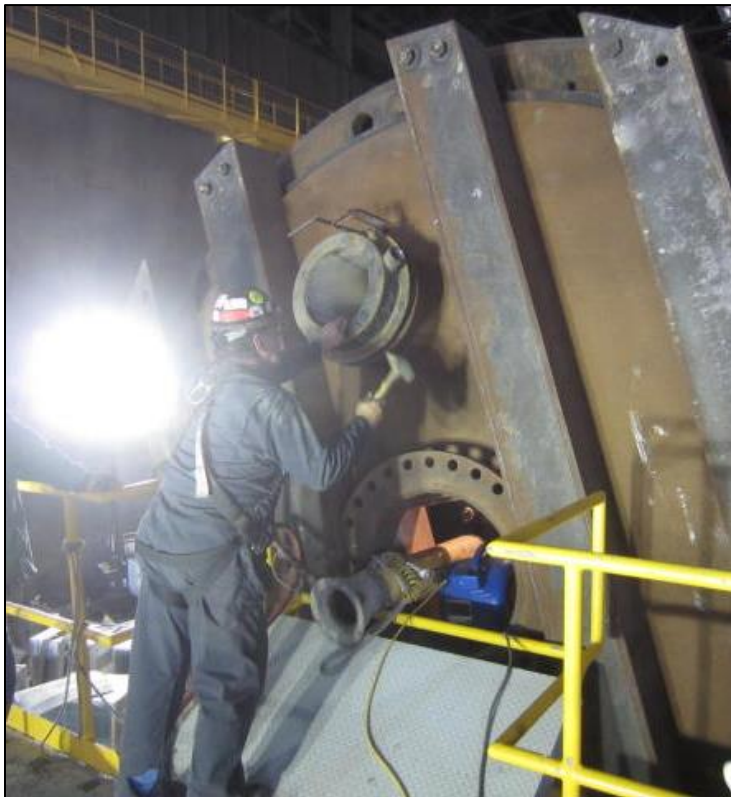
Fig. 51 Se utiliza iluminación en este espacio confinado
