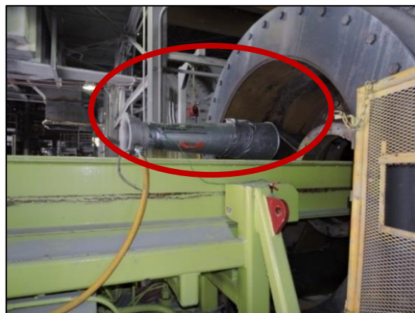
Fig. 37 Ventilación en uso en un molino de bola
