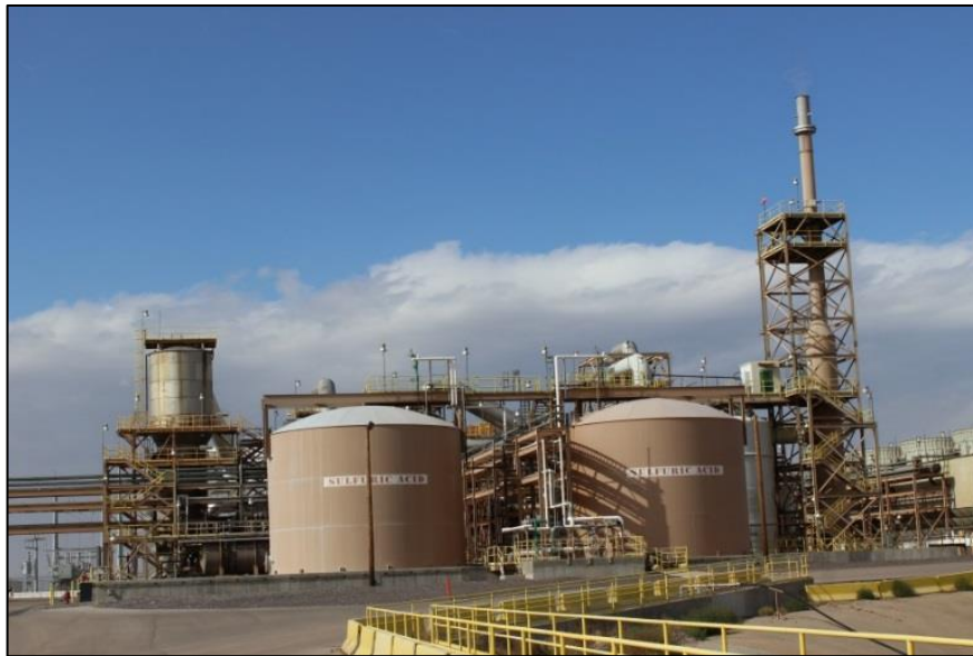
Fig. 17 Potencial de vapores, gases y humos en plantas de ácido sulfúrico
