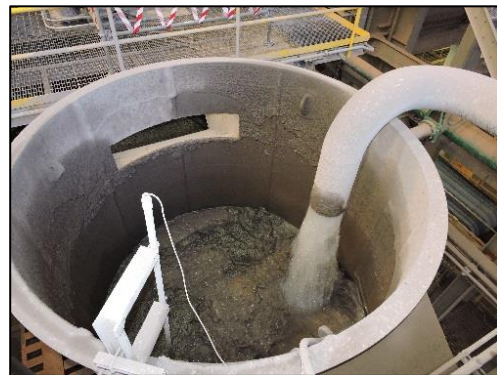
Fig. 21 Potencial de atrapamiento en este tanque
