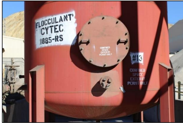
Fig. 26 Los químicos se almacenan en tanques
