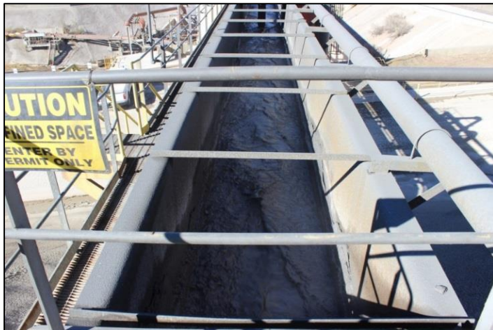
Fig. 4 Los lavadores de residuos tiene lugares de entrada y salida limitada
