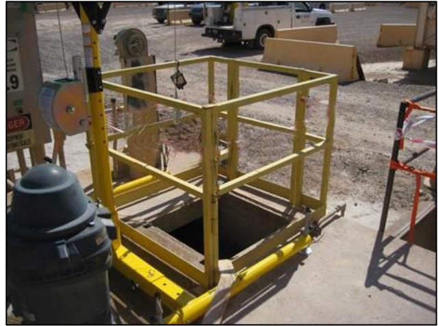
Fig. 50 Baranda temporal que protege una abertura
