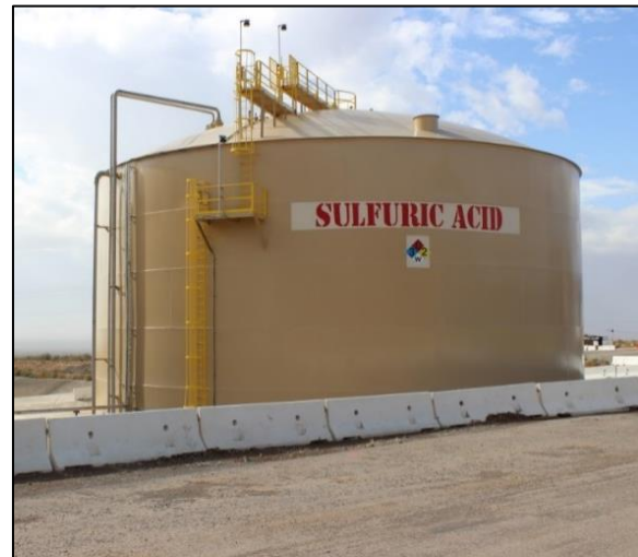
Fig. 6 Un tanque de ácido es una atmósfera peligrosa
