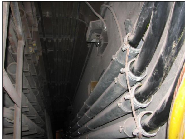
Fig. 23 Contratistas eléctricos debajo de un concentrador
