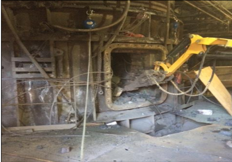
Peligro(s) de caídas
