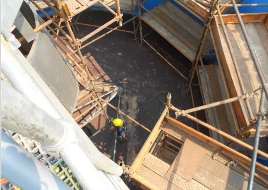
Peligro(s) de caídas
