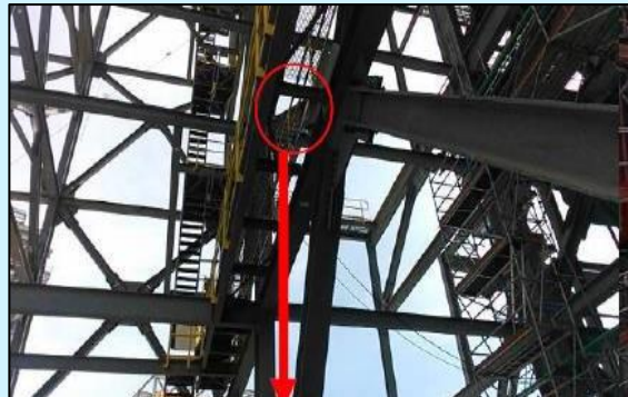
Fig. 16 Brecha entre las secciones de la malla
