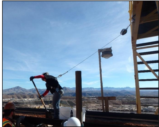
Fig. 45 Empleado que usa un sistema de detención de caídas
