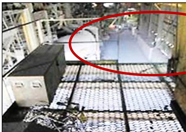
Fig. 5 Plataforma de la bahía de la grúa con puerta faltante
