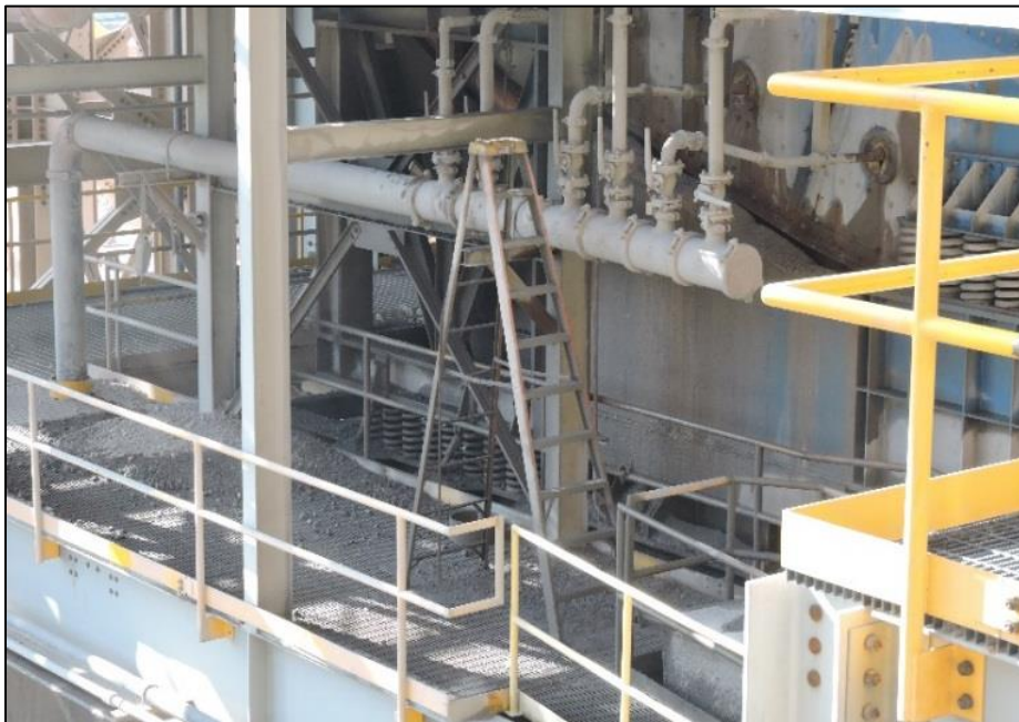
Peligro(s) de caídas
