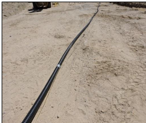
Figura 3.2 Indicador/cable rastreador en un conducto eléctrico o líneas de gas
