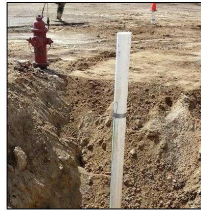
Figura 3.1 Cable rastreador pegado al conducto sobre el nivel
