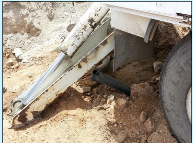
Figura 1.3 Colocación incorrecta de una grúa
