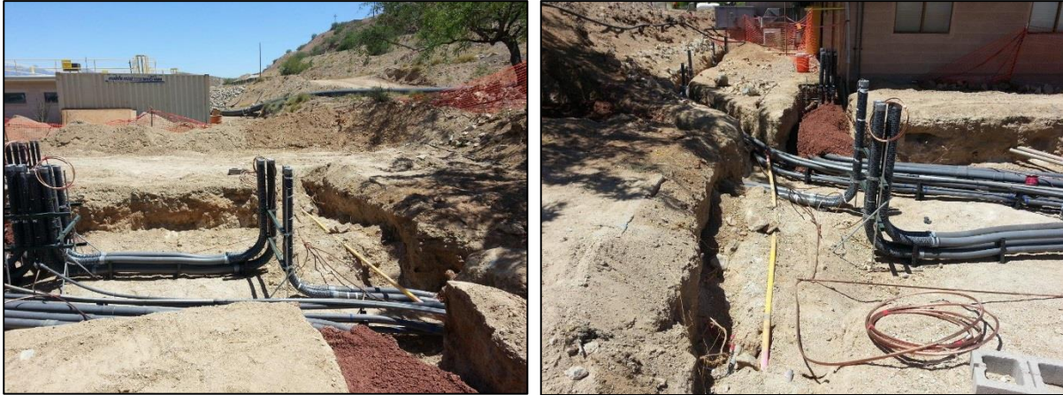
Figura 3.11 Zanjeo completado para la instalación de conducto eléctrico, mostrando servicios públicos encerrados en concreto con tinta roja.
