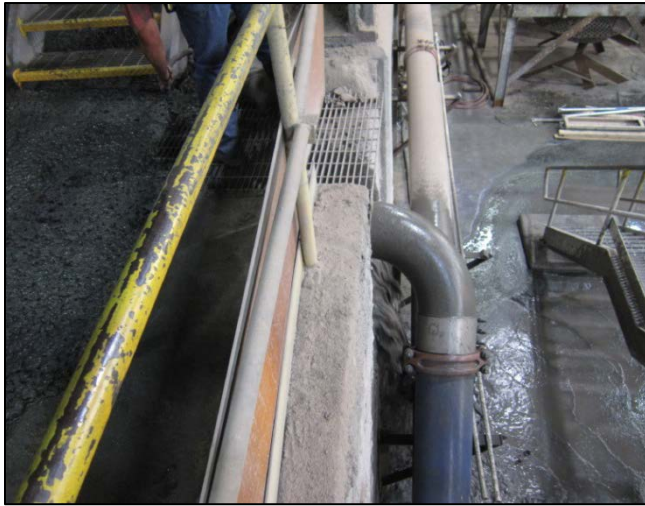
Fig. 3.20 El derrame de materiales lleva a incidentes de resbalones.
