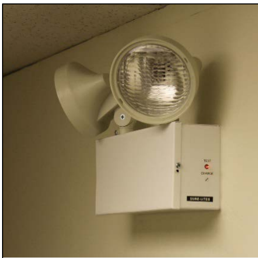
Fig. 3.29 Iluminación de emergencia.
