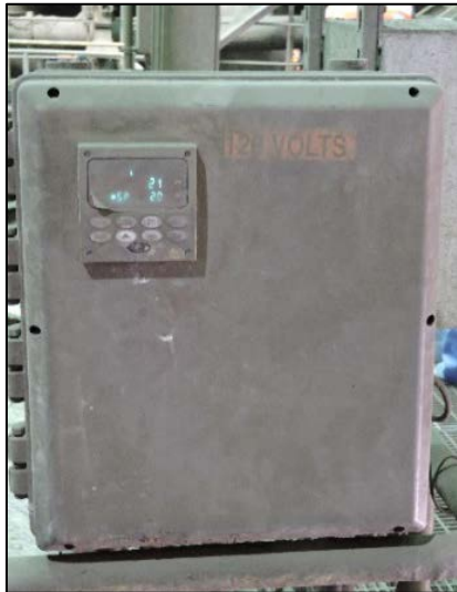
Fig. 3.13 Etiquetado que es difícil de leer.
