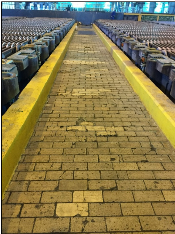
Fig. 3.21 Vía de tránsito segura en un tanque de electrólisis.
