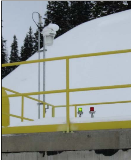
Fig. 3.28 Alarmas de emergencia.
