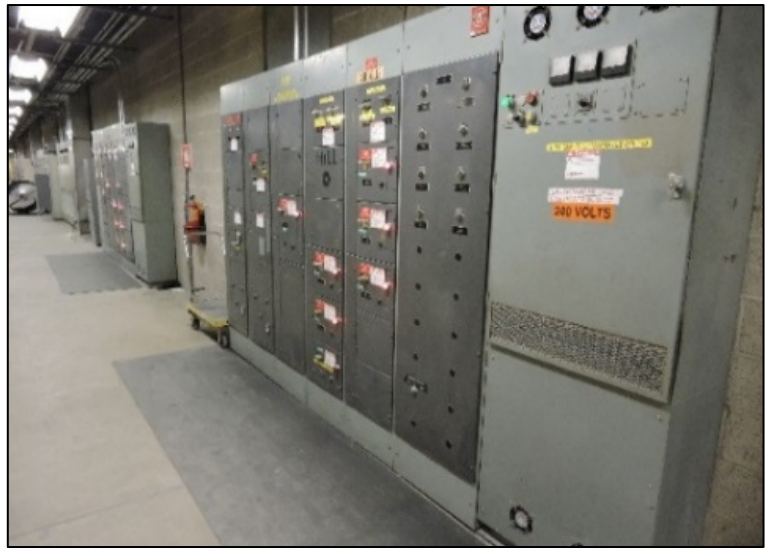
Fig. 3.7 Paneles eléctricos en un área de trabajo.
