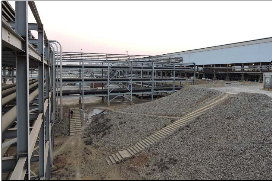
Fig. 2.7 Riesgo de pendiente mitigado con un control de ingeniería (escaleras).
