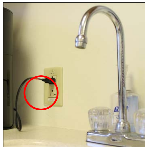
Fig. 3.12 GFCI en un tomacorriente cerca de un lavabo.
