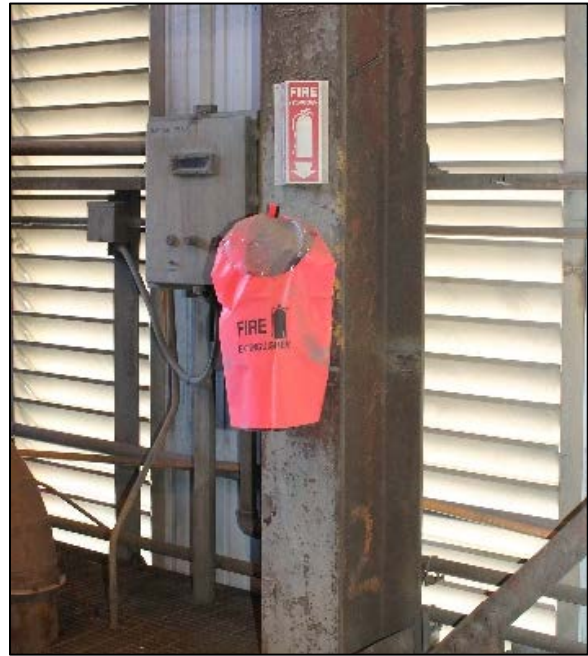
Fig. 3.26 Extintor de incendios en el lugar de trabajo.
