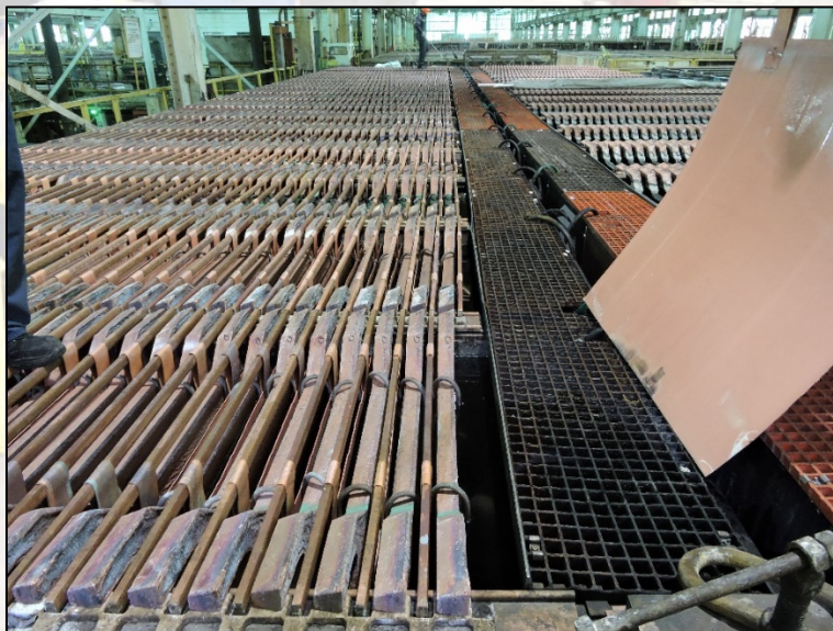
Fig. 1 Un cátodo faltante origina un riesgo. Permanezca consciente de los riesgos mientras trabaja.
