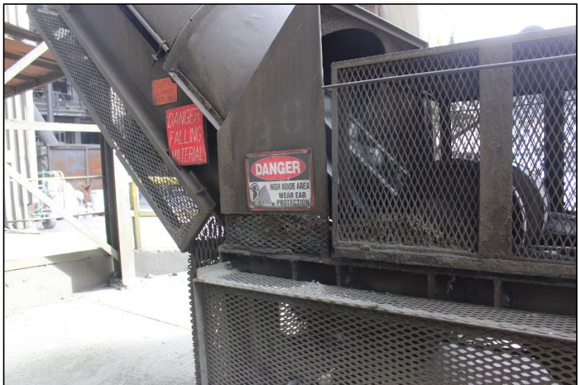
Fig. 3.4 Los protectores adecuados resguarda a los empleados de las partes en movimiento.
