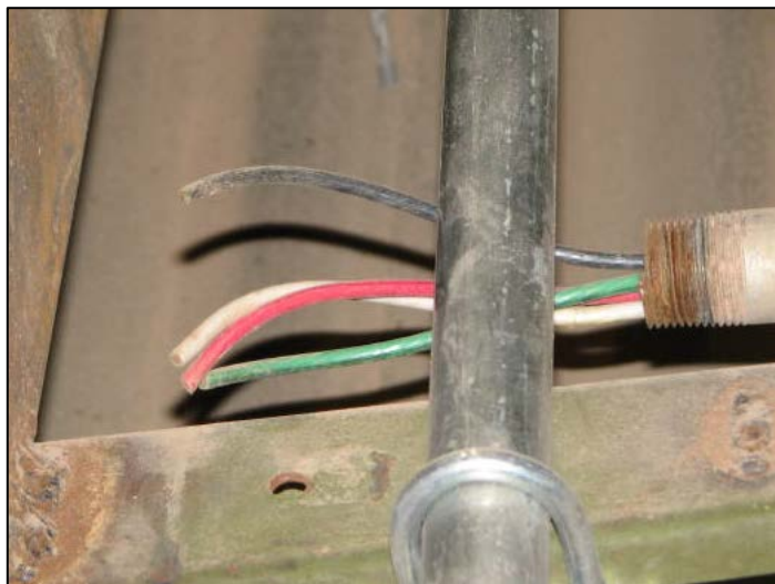
Fig. 3.10 Broken wires in a conduit.
